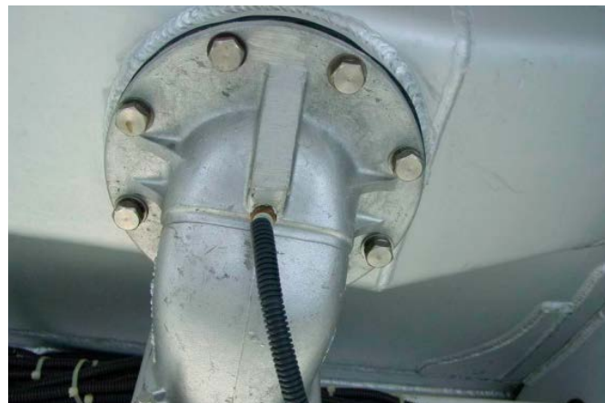
Ventil na komori
