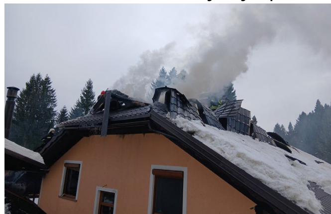
Požar uništio veći dio krovšta
