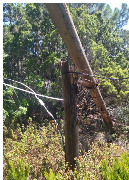
Štete na električnoj infrastrukturi
